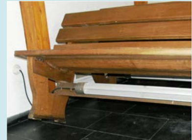
Elektrodirektheizung (als Bankheizung)
