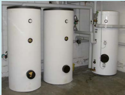
Großanlage (Puffer- und Trinkwarmwasserspeicher)
