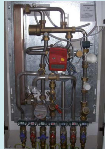
indirekte Übergabe als Übergabestation (Heizung und Warmwasser)
