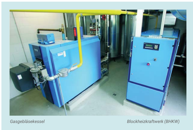
Abb. 48: Heizzentrale mit Blockheizkraftwerk und Kessel (Quelle: Buderus)
